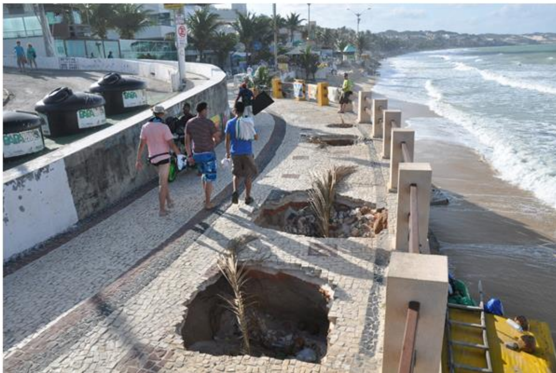
Figura 2: Painel superior: Praia de Ponta Negra, com destaque para o calçadão destruído e Morro do Careca ao fundo. Painel inferior: Note a estreita faixa de areia e os danos à fundação do calçadão. Fotografias obtidas em: http://sospontanegra.org .
